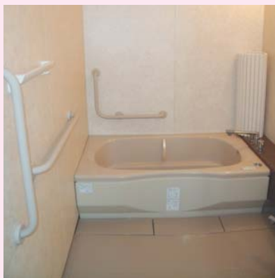
浴室内・浴槽付近の各種手すり
